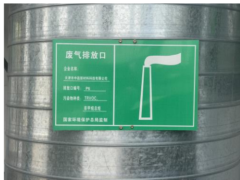
P6 排气筒标识牌
