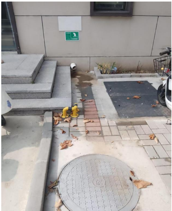
污水排放口规范化
