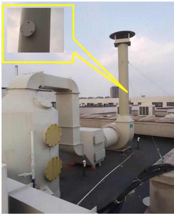
P1 排气筒、采样平台、规范化
