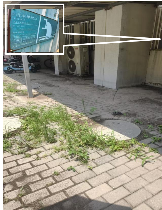
二厂污水总排口规范化
