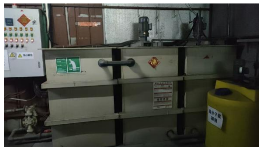
车间设施排口
